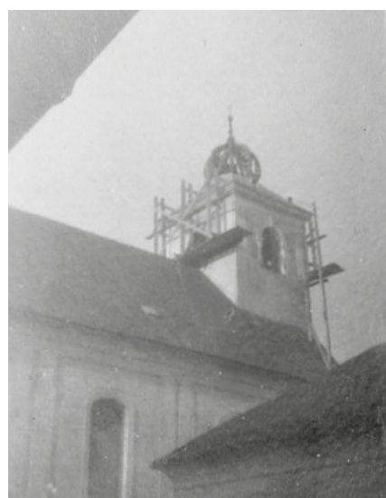
Rok 1932, kdy se místo bobrovky dával na věž mě-děný plech, který s konstrukcí vydržel do roku 2013
