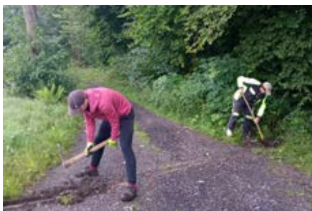
Údržba, která by mohla odblokovat odtok vody.
