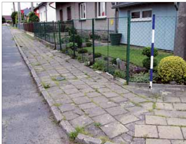
Stav chodníků před rekonstrukcí...
