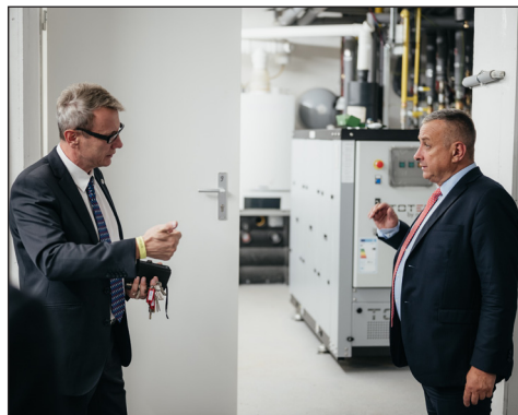
Starosta obce Michael Rataj seznámil ministra průmyslu a obchodu Jozefa Síklu při obhlídce fotovoltaické elektrárny a instalovaných technologií s praktickými problémy, které brání spuštění provozu.
