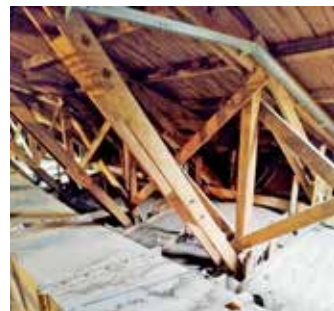
Neizolovanou střechou léta uniká teplo.
