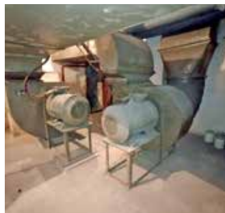
Nefunkční vzduchotechnika ve sklepních prostorách.
