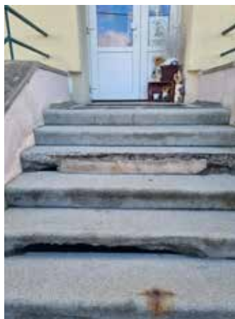
Nebezpečně vyhlížející schodiště...
