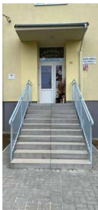
...po rekonstrukci prokouklo.
